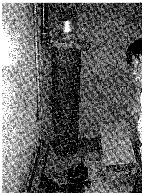
写真36 暖気のボイラー
