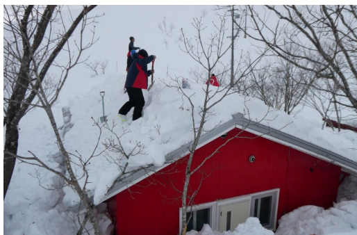
写真 5-2 屋根から下ろした雪で，下地の雪が高くなった。(3/12)
