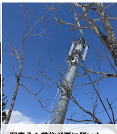
写真 7-1 電柱が更に傾いた。 結果、上部ポールが破断 (3/22)
