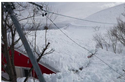
写真 5-4 西側の軒も同様。電線はまだ落下していない。(3/12)
