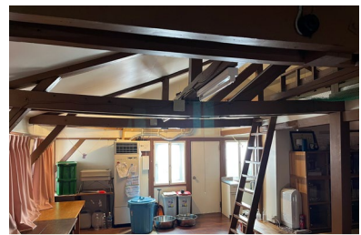
写真 4-2 梁がたわんでいる。(3/10)。
