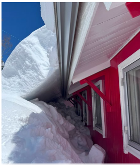
写真 6-1 屋根雪がずり落ちる。(3/20)
