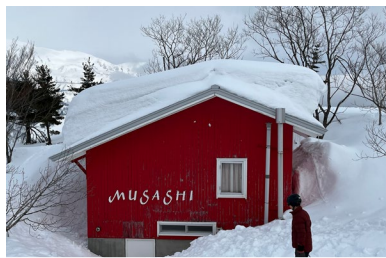
写真 4-1 屋根雪の一部が落下している。(3/10)
