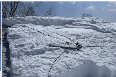
写真 7-2 電柱上ポールが折れ，ガイシと電線が落下。
