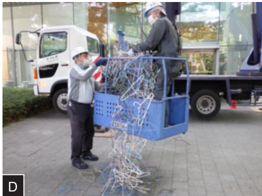
D. クレーンで回収されたカラスの巣
