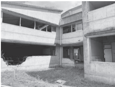
＜写真7＞道路側からみた被害 の爪痕が伺える旧校舎
